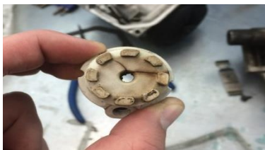
Рисунок 3 – Трещина керамического элемента
