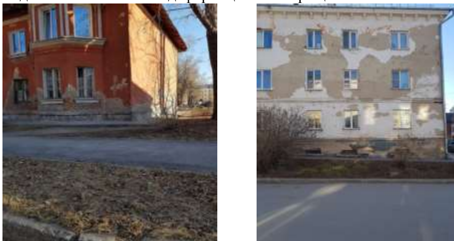
Рисунок 1 – Примеры оштукатуренных фасадов в сибирских условиях после нескольких лет эксплуатации
