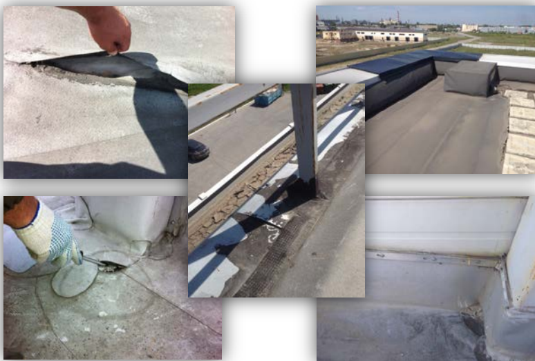
Рис.2. Примеры некачественно выполненных кровельных работ
